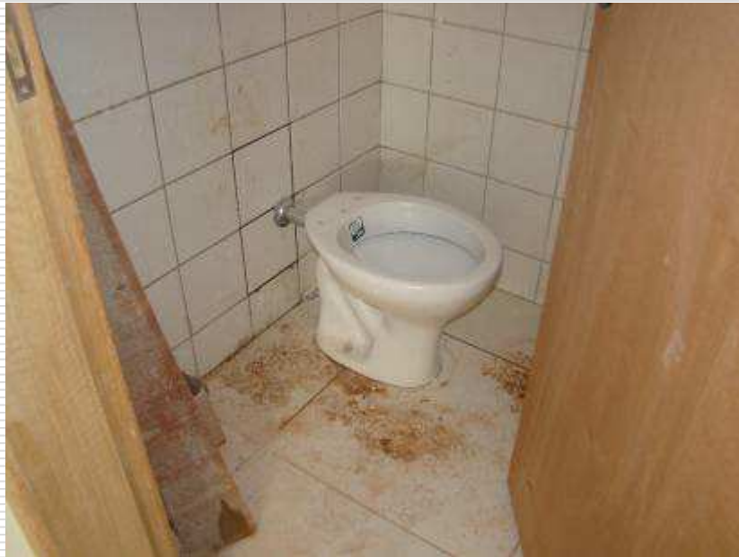
Detalhe da louça (bacia sanitária) instalada no banheiro
