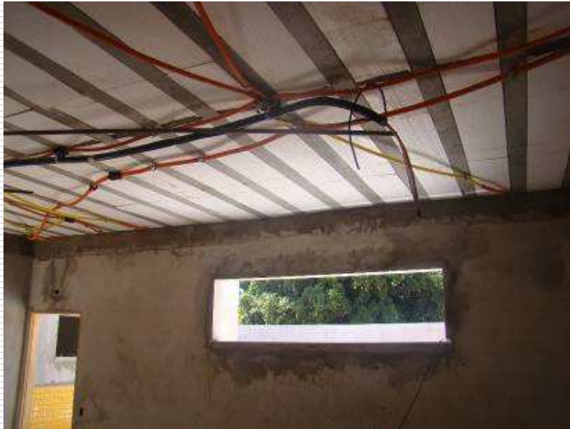
Detalhe do dreno e tubulação frigorígena – infraestrutura para ar condicionado
