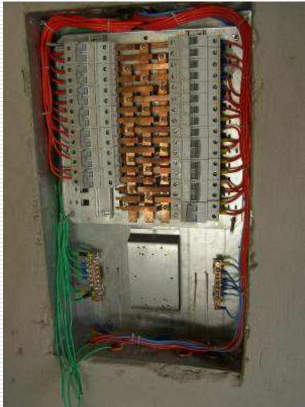
Detalhe dos disjuntores
