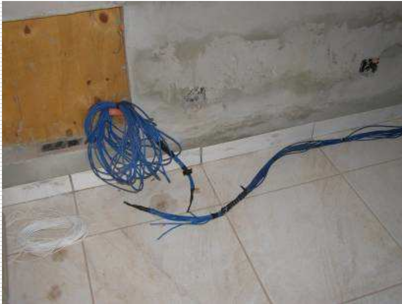
Detalhe do cabeamento estruturado. Cabo flexível UTP Cat. 6
