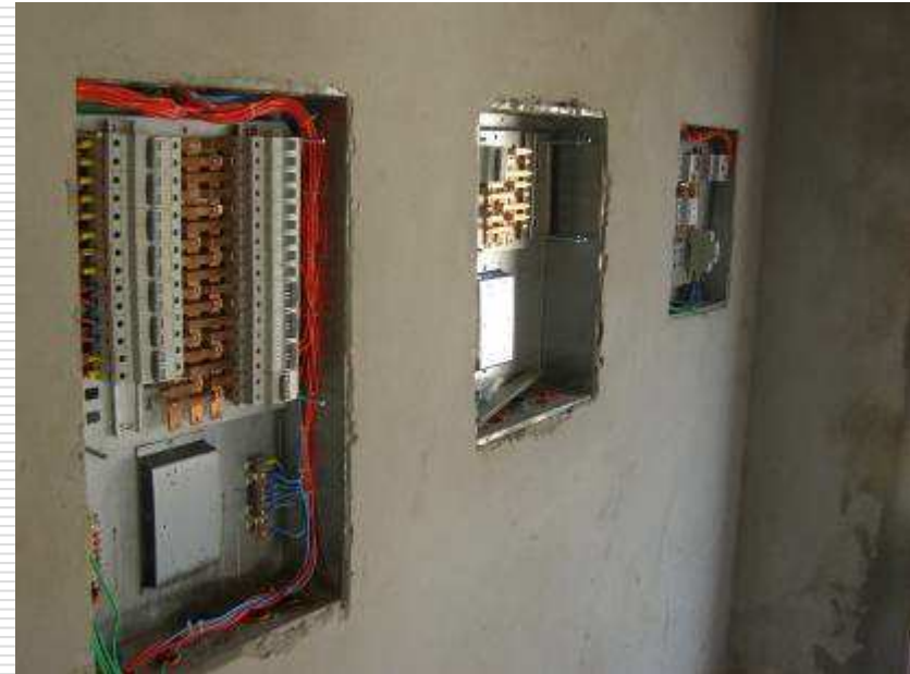
Detalhe dos quadros de distribuição
