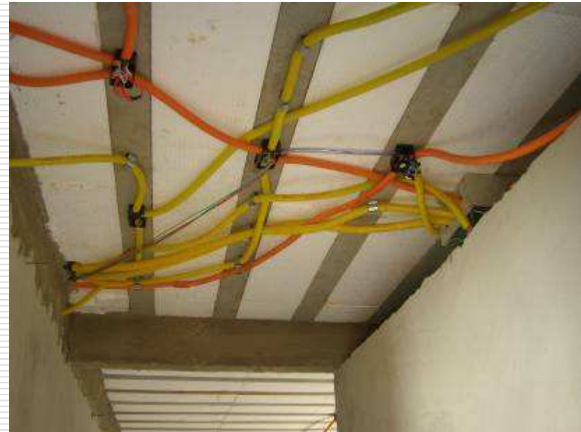
Detalhe das caixas de passagem de aço estampado e das mangueiras para passagem de cabos elétricos
