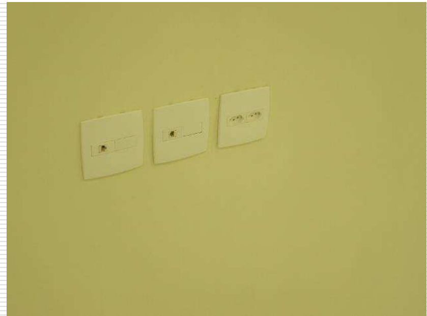
Detalhe das tomadas de elétrica e lógica
