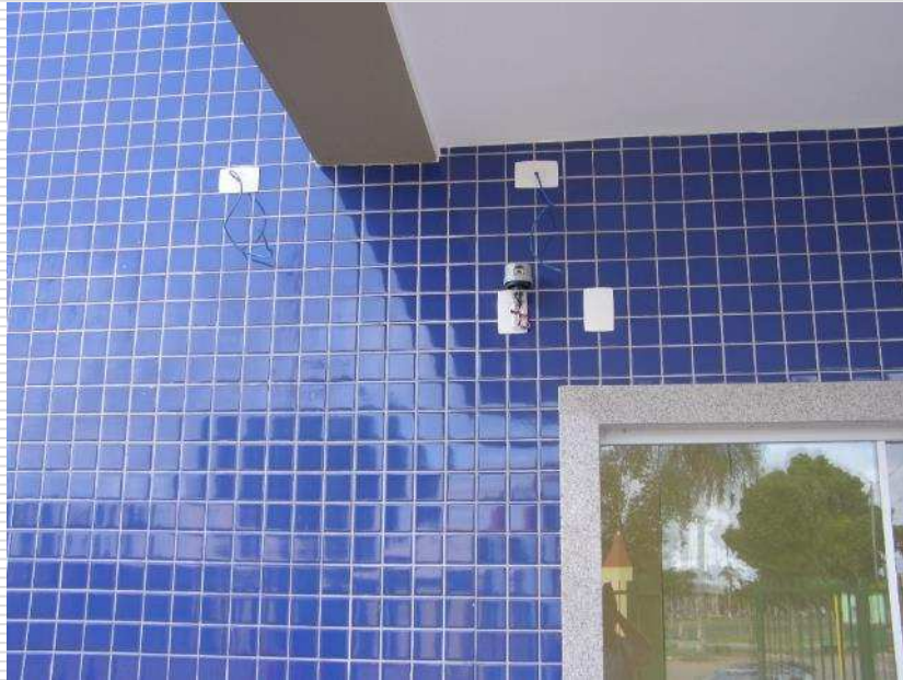
Detalhe do sensor de luminosidade e dos pontos de lógica para câmeras de segurança
