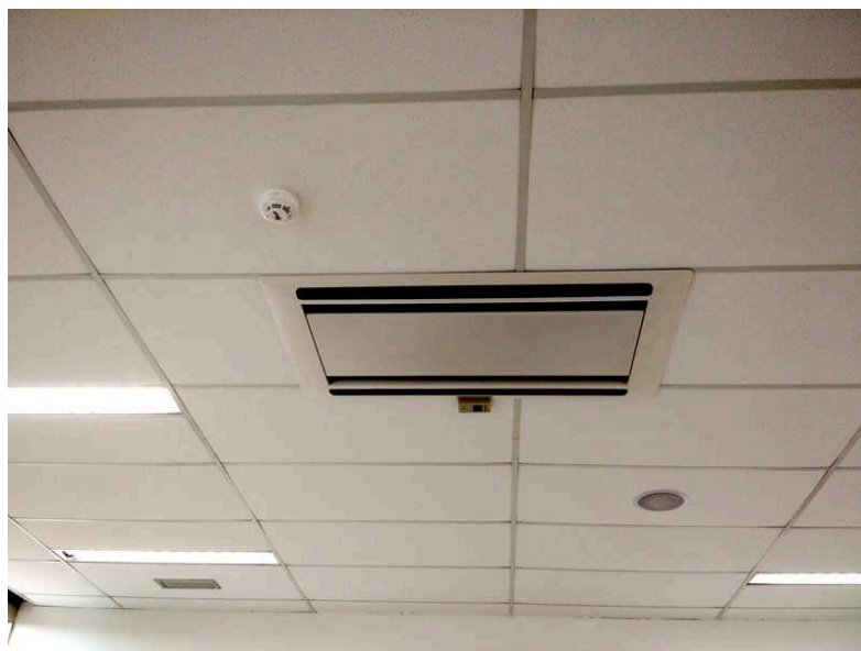
FOTOS DAS EVAPORADORAS DO SISTEMA VRF (Localização: ambiente interno)
