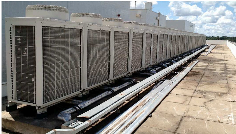
FOTOS DAS CONDENSADORAS DO SISTEMA VRF (Localização: cobertura predial)
