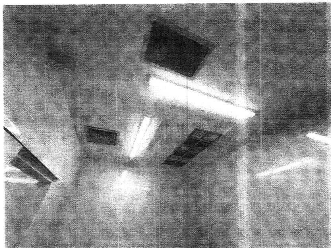
Foto 8 – Rede de dutos- Sala de Extração
