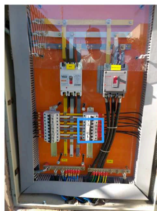
QGBT (Disjuntor Trocado)
