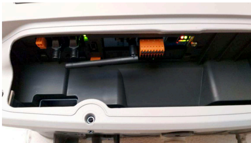
Status normal da Placa de rede do Inversor 1
