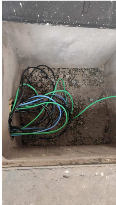
Caixa de passagem - Detalhe dos cabos flexíveis de corrente alternada CA
