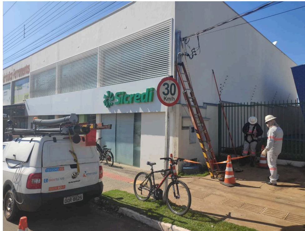
Foto da equipe da Energisa na entrada de energia
