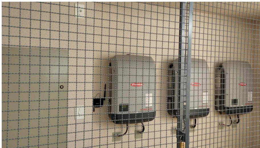
Detalhe da instalação das inversoras
