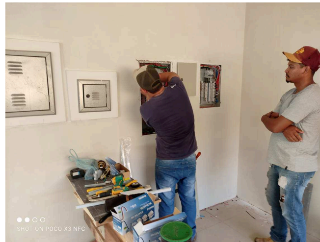
Detalhe do quadro de distribuição com todos os disjuntores novos no padrão brasileiro
