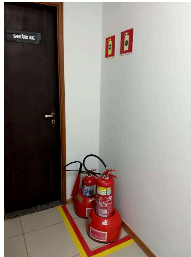
Extintores, placa de identificação e sinalização horizontal
