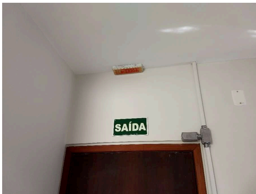
Detalhe de placa de sinalização de rota de fuga e iluminação de emergência
