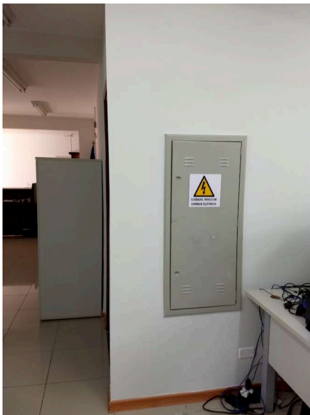
Detalhe da placa de alerta a choque
