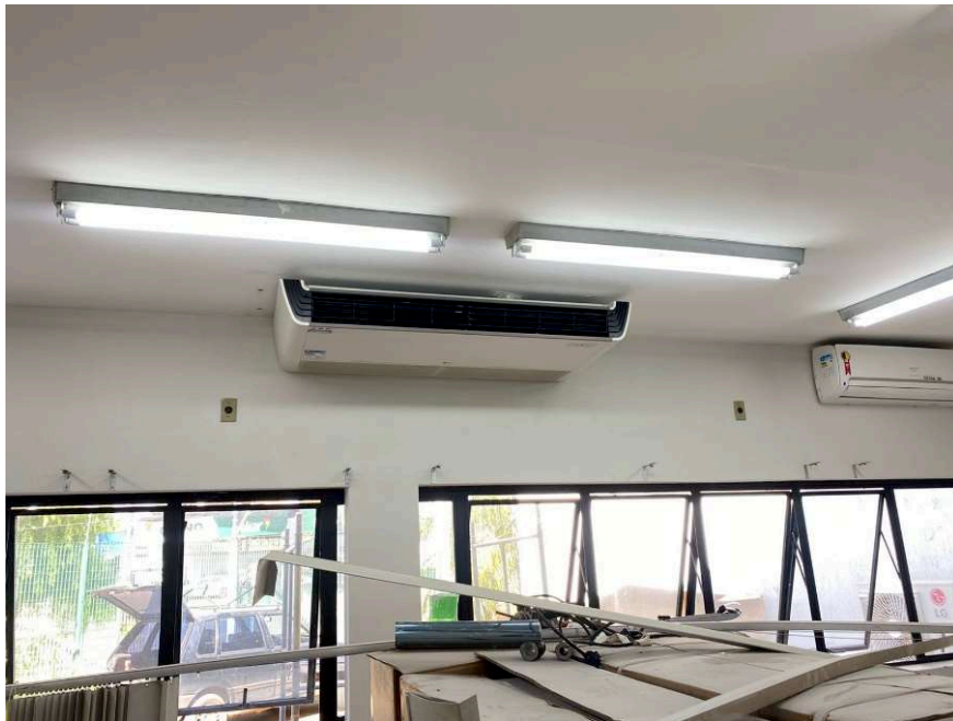
Detalhe do equipamento novo de 4TRs, instalado na secretaria
