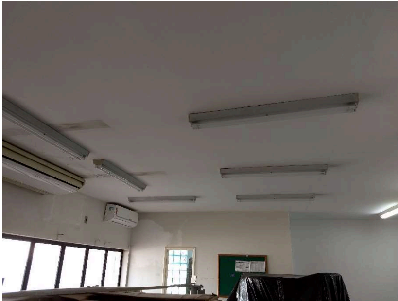
Detalhe das calhas com as lâmpadas leds
