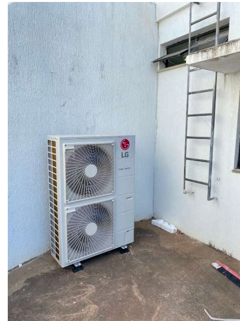
Detalhe da condensadora de 4TRs
