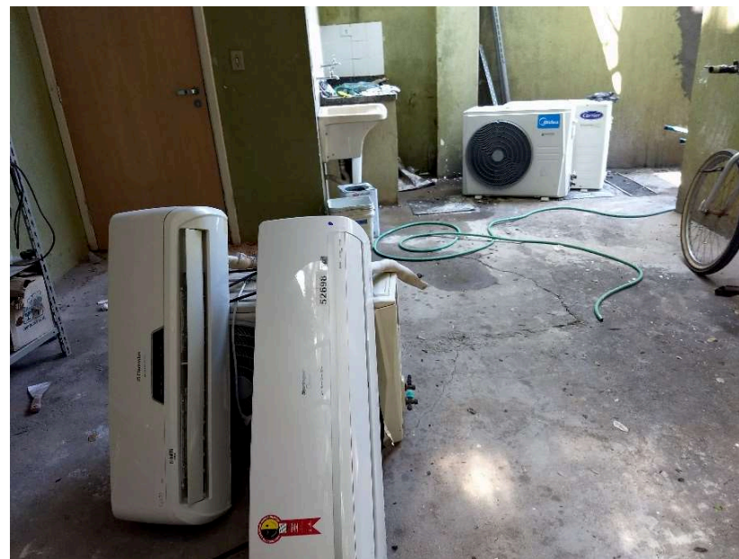
Detalhe dos aparelhos de ar condicionados limpos e prontos para a reinstalação
