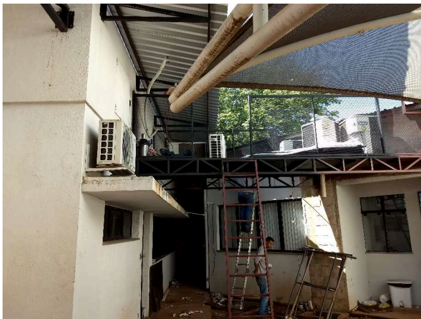
Detalhe da passarela técnica com as condensadoras
