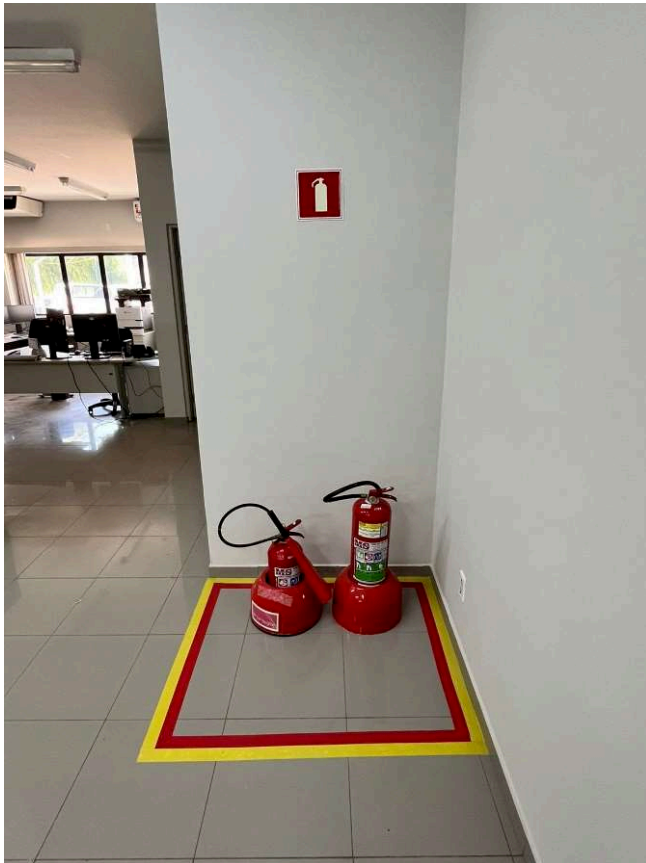
Detalhe de adesivo de piso com demarcação de extintor.
