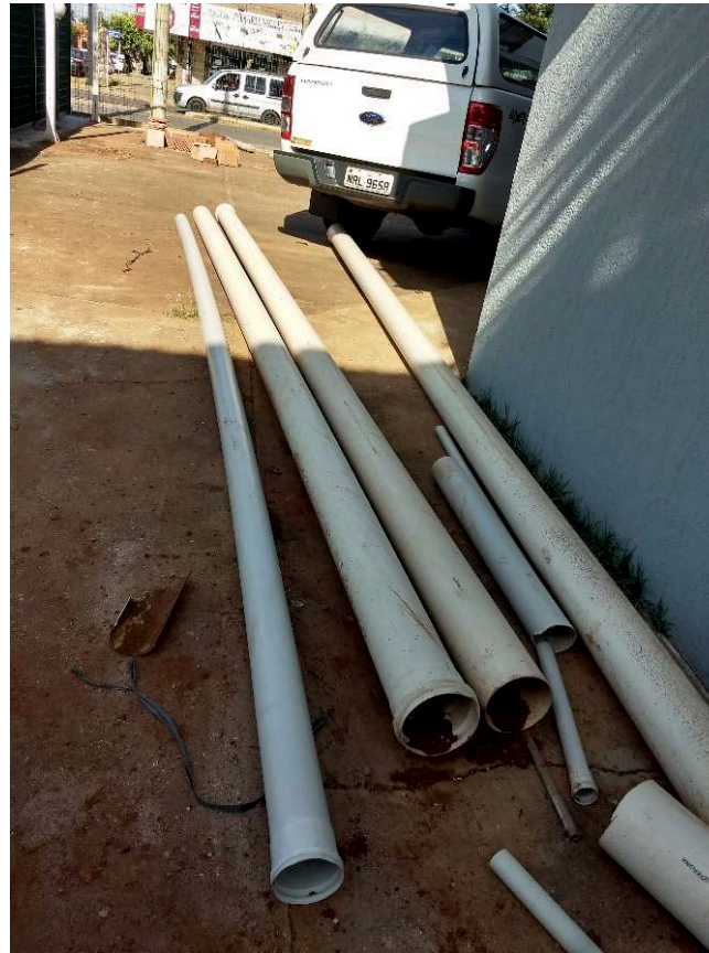
Detalhe de tubo PVC de esgoto predial.
