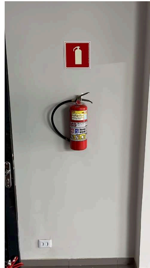
Detalhe de extintor de incêndio portátil
