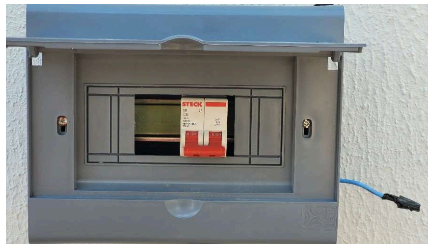
Quadro de distribuição de energia
